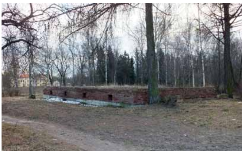
Разрушающийся фундамент, на котором должны были восстанавливать кирху. Тропинка на переднем плане — начальная часть Медвежьего переулка
